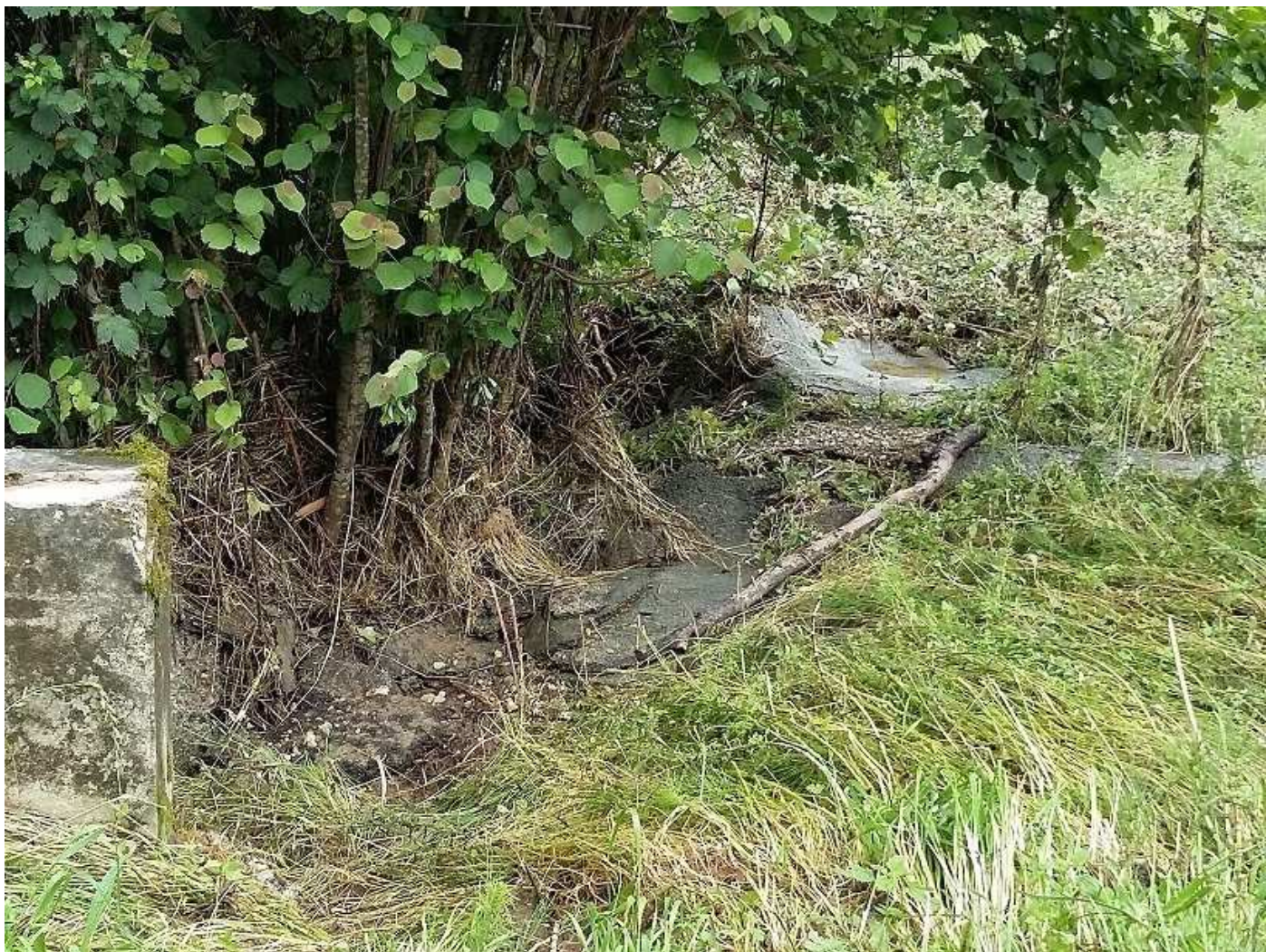
À Saint-Vivien-de-Monségur, des plaques de goudron, sur la D230, ont été soulevées et transportées par les eaux sur le bas-côté. (©Le Républicain Sud-Gironde)
